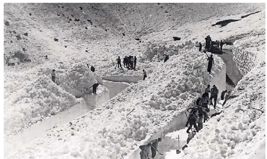
Rund 30 Wegknechte stehen zur Öffnung der Passstrasse zum Gotthard im Einsatz. Mit dem Ausschaufeln der Passstrasse war die Arbeit nicht getan; es musste auch Platz für den ausgehauenen Schnee geschaffen werden. Über die Anzahl Arbeiter, die Dauer der Arbeiten sowie das Datum der Öffnung gibt der Rechenschaftsbericht leider keine Auskunft.
